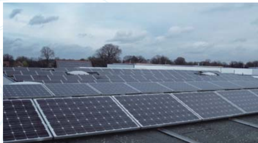
ドイツ・2.5MW 太陽光発電所
