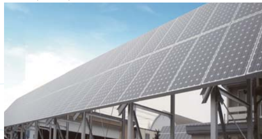
北海道・54KW 太陽光発電所
